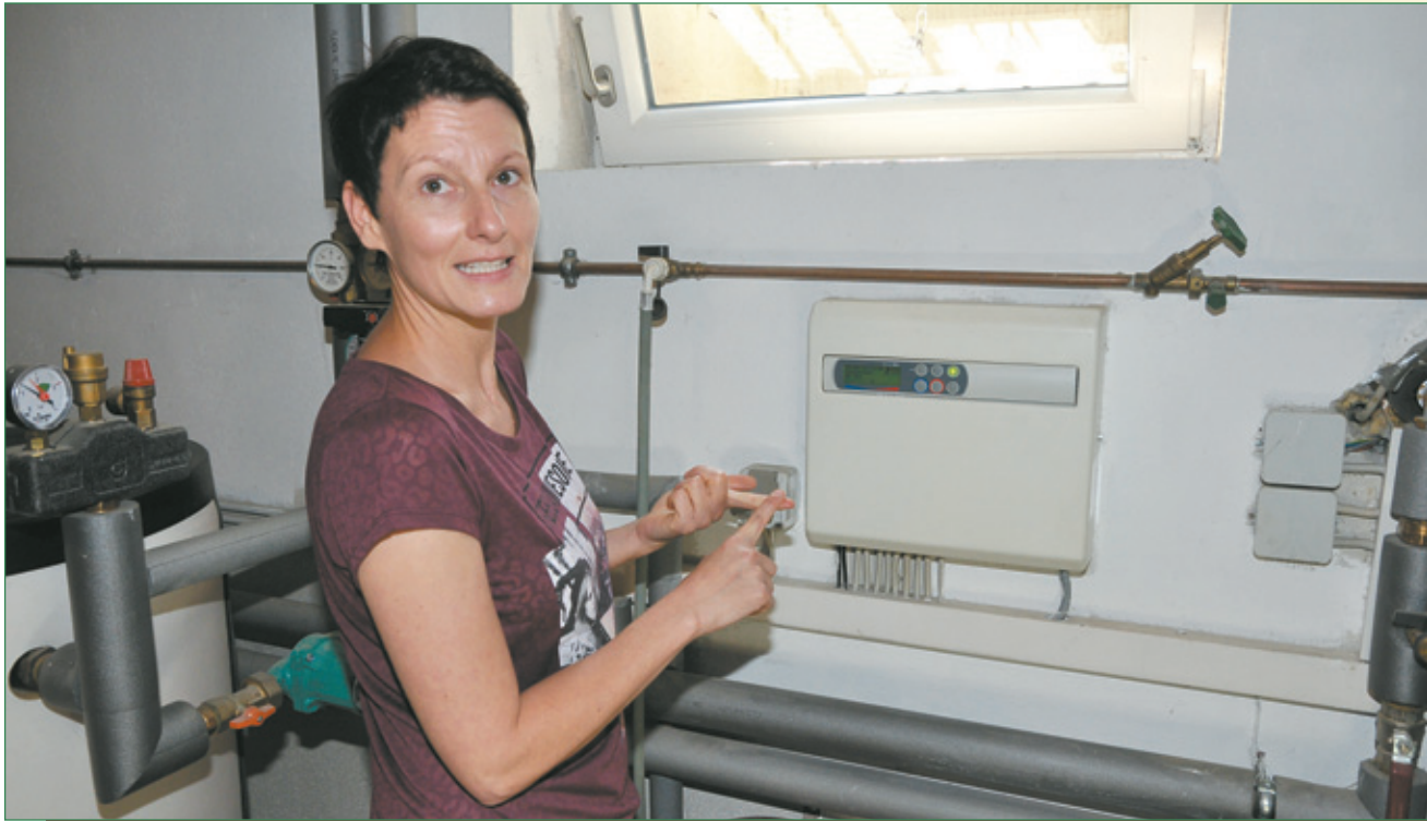
Knotenpunkt: Hier wird die mit Öko-Strom von MANN betriebene Wärmepumpe gesteuert, erläutert Ute Baldus.
