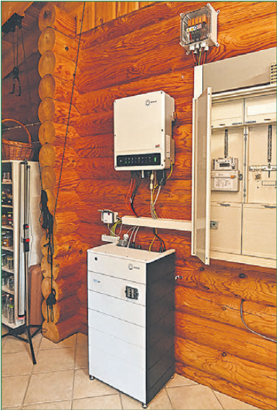
Speicher: Wie ein kleiner Schuhschrank sieht die Batterie im Haus aus, in der Abels 8,8 kW/h ihres PV-Stroms „aufbewahren“.
