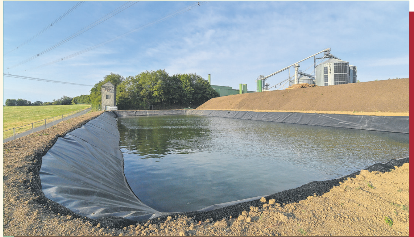
Bauprojekt: Bei dem „Umzug“ erfolgt eine Verdoppelung der vorgehaltenen Wassermenge auf 1,8 Millionen Liter.
