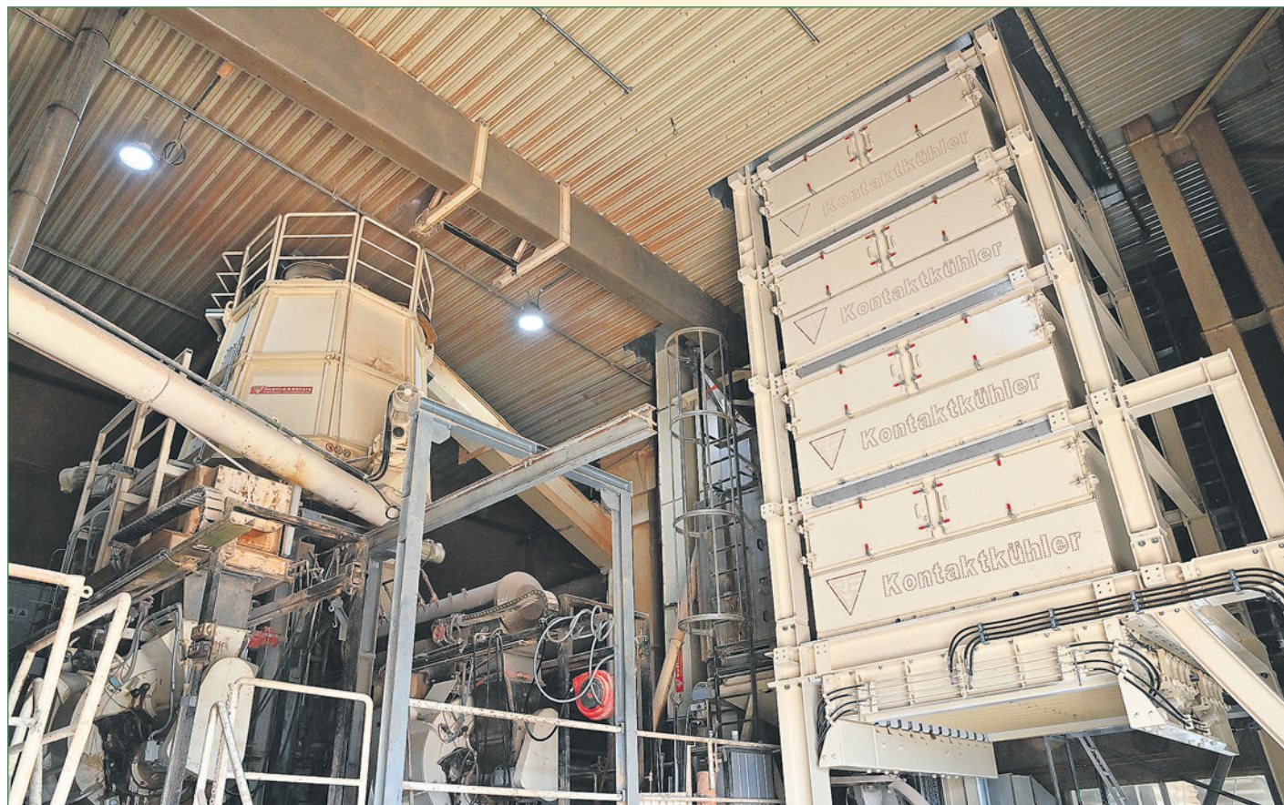
Methode: Der Wärmetausch erfolgt direkt im Kühler (rechts) neben den Pelletpressen.
