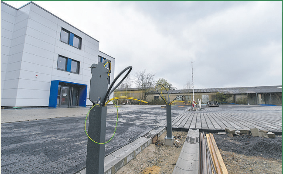
Parkplatz: An jeden Standfuß werden zwei Ladepunkte gehängt. In wenigen Tagen können E-Autofahrer hier während der Arbeitszeit „tanken“.
