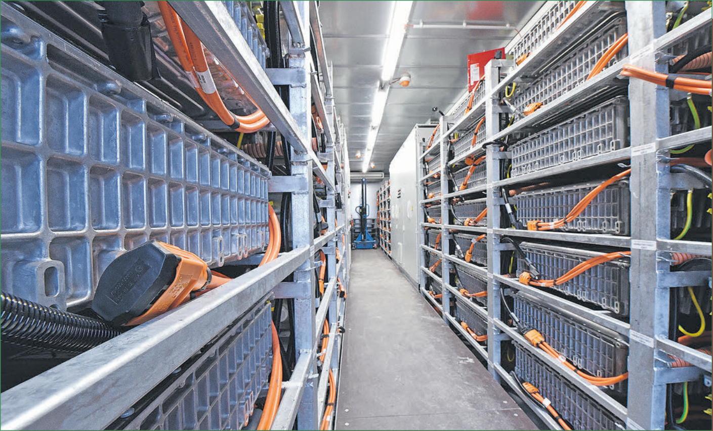
Verbindung: Dicke Kabel machen aus 112 Akkus einen Großspeicher, der beeindruckende 1,4 MWh Kapazität bietet. Fotos: Schmalenbach
