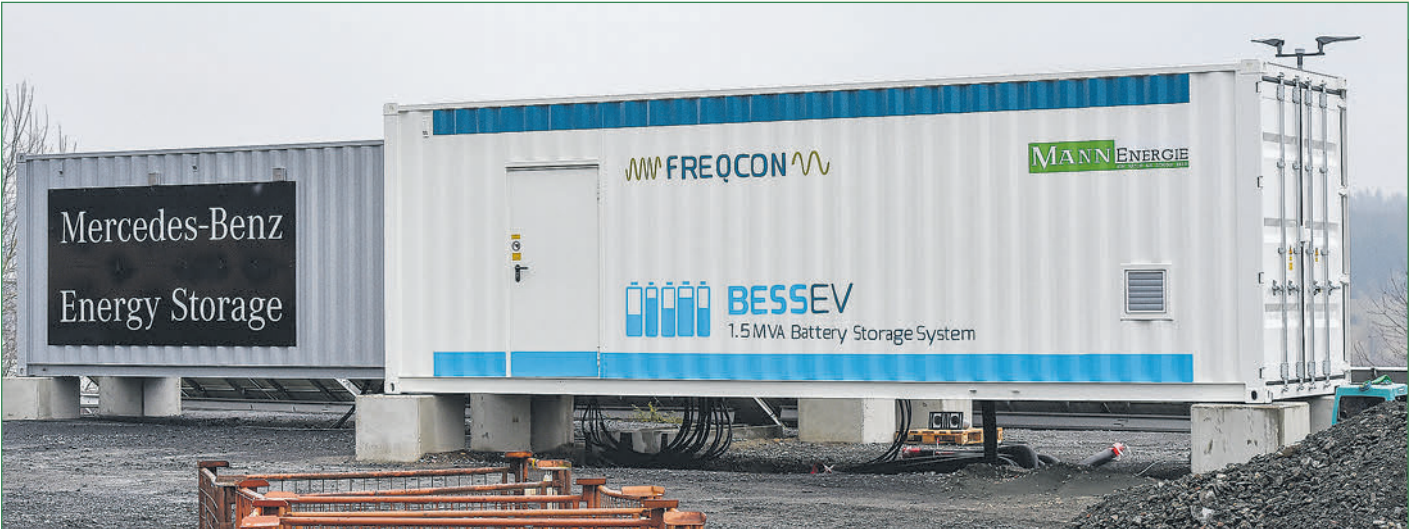
Container: Von außen eher unscheinbar, ist die Technik im Innern ein Novum.
