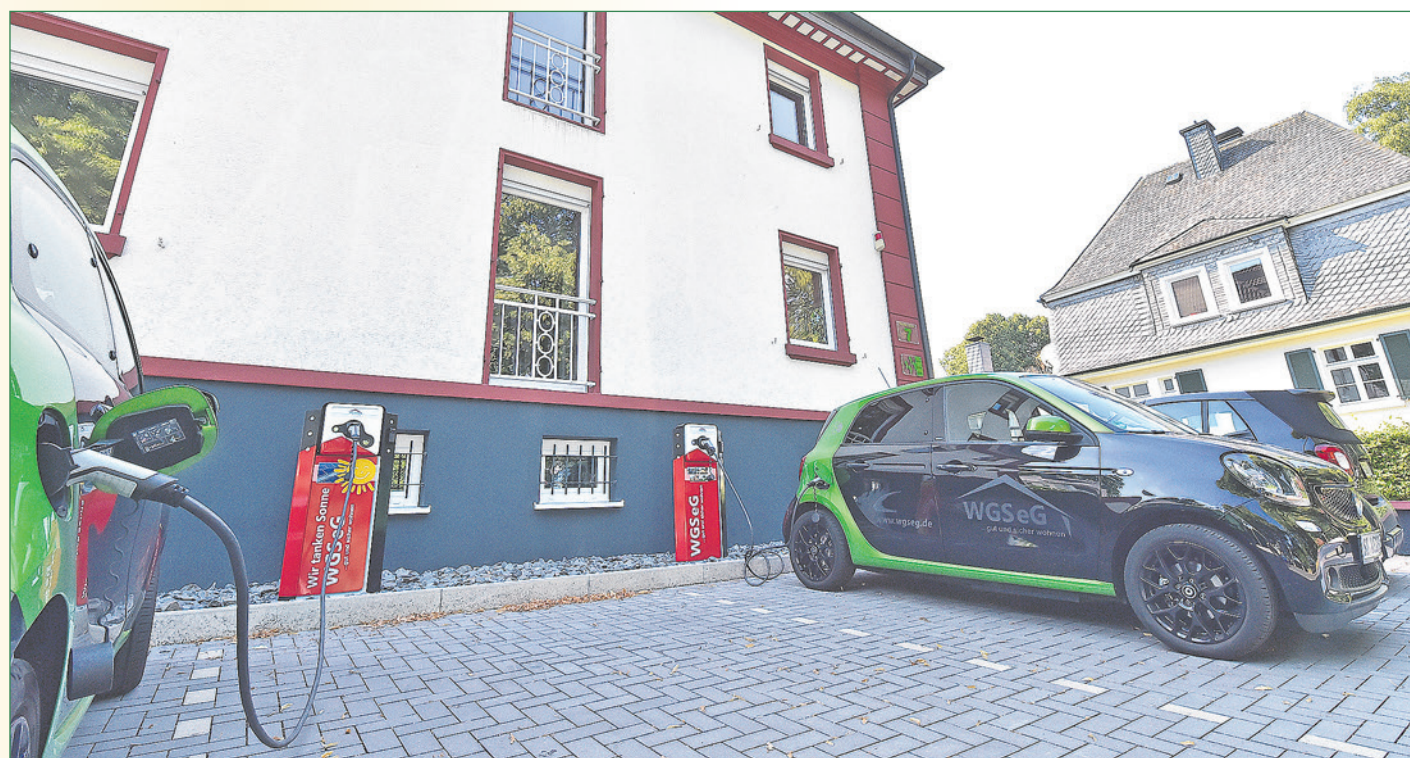
Fortschritt: Vor der Wohnstättengenossenschaft Siegen befinden sich seit Mai fünf Stromtankstellen. Die Ladeplätze entstanden in Kooperation mit MANN. Foto: Schmalenbach
