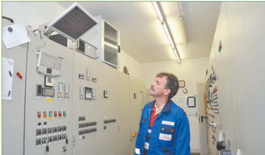
Kontrolle: Bei Störungen muss zuerst der entscheidende Kraftwerksteil lokalisiert werden.
